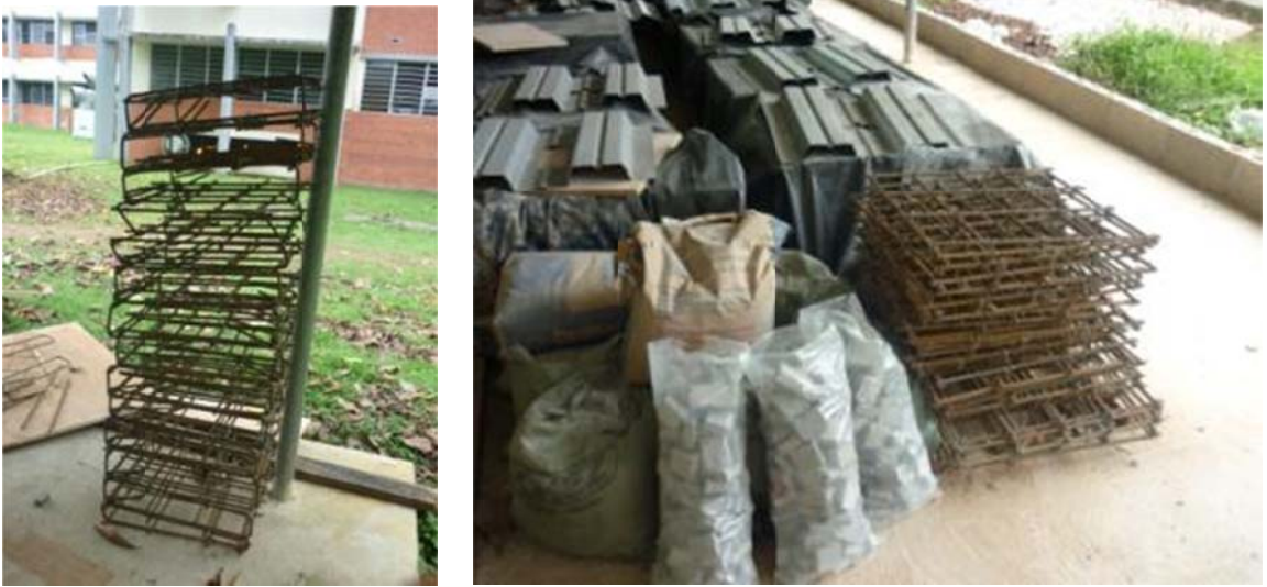
Figura 1. A la izquierda se muestra detalle del refuerzo de los especímenes de losa sólida y a la derecha se muestra las calzas utilizadas como recubrimiento y el refuerzo de los especímenes de losa con lámina.
